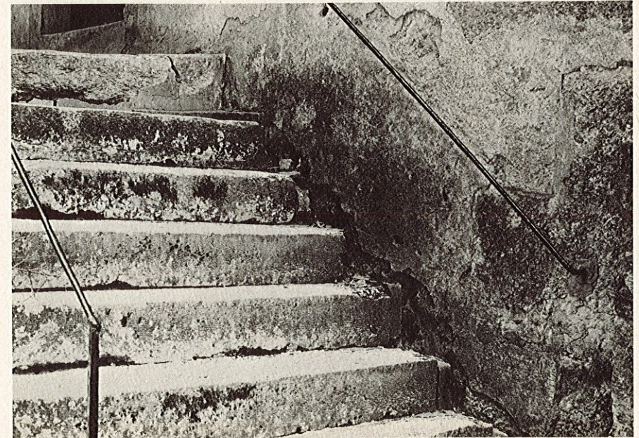
85 Der Treppenaufgang zur St. Martins-Kapelle muss völlig erneuert werden
